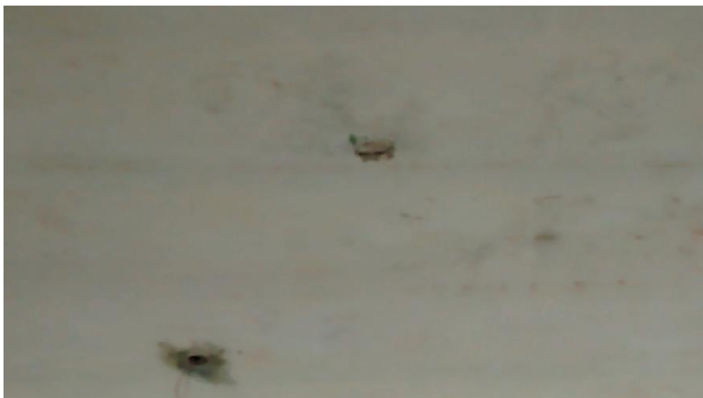
Foto 02: Pintura danificada juntamente com ausencia de Luminárias;
