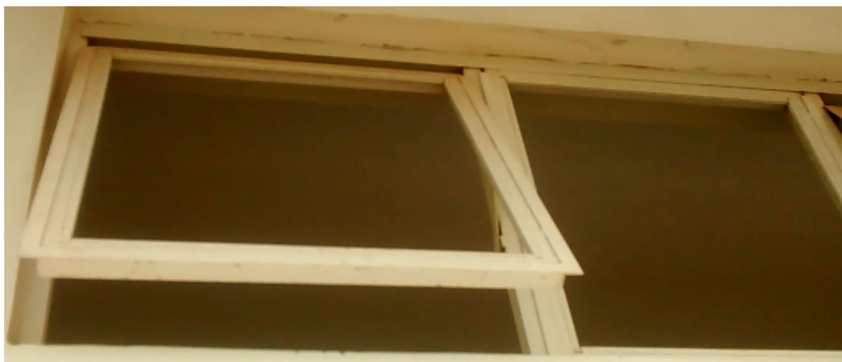
Foto 01: Esquadrias sem vidros;
