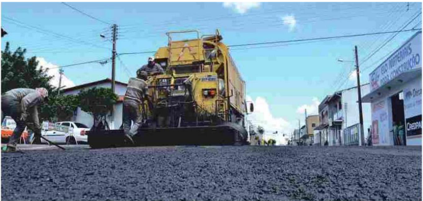
Avenida recapeada no município de Catalão, no Sul Goiano, parte do Programa Rodovia Urbana: investimento global de R$ 185,4 milhões em 124 municípios
